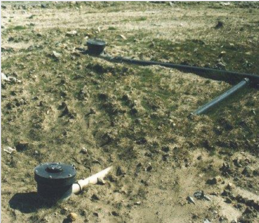
Sistema de drenagem de biogás
