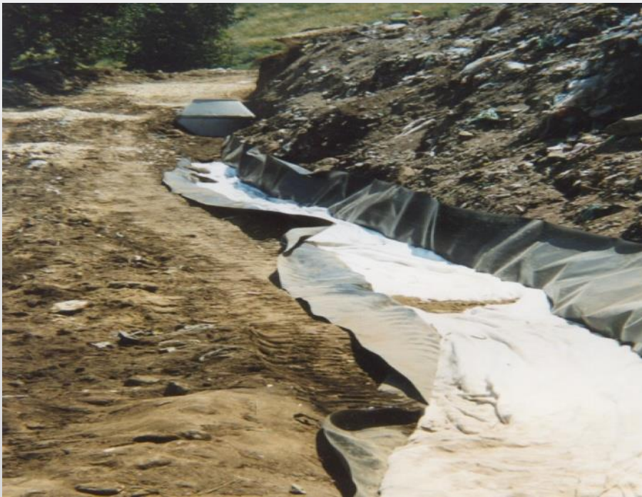
Sistema de drenagem de águas lixiviantes
